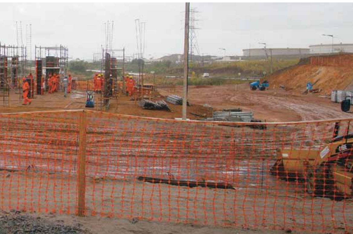
Obras da extensão do trecho Complexo Viário e Logístico Suape, em Pernambuco, sob a concessão da CRA.
